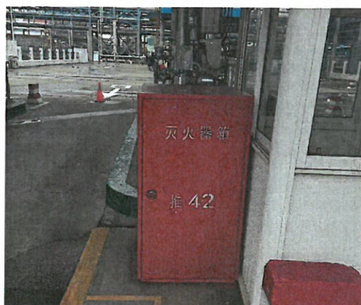
装车站消防设施
